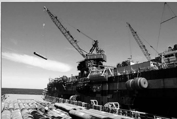
Lossing: Vel framme ved rørfartyet LB200 er to kranar i sving med å løfte opp eit og eit røyr. To av matrosane på Havila Harmony har som oppgåve å feste wira på kvar ende av røret før det går til værs. Lasta på 167 røyr utgjer 2 km av den 1.200 km lange leidningen. På LB200 vert to og to røyr sveisa saman i fleire operasjonar. Ein «skyt» deretter riggen fram 25 meter med at fartyet dreg seg fram på wirar som er festa til fleire anker framanfor riggen. Rundt LB 200 går det båtar som flyttar ankera framover etter kvart som riggen dreg seg fram.
